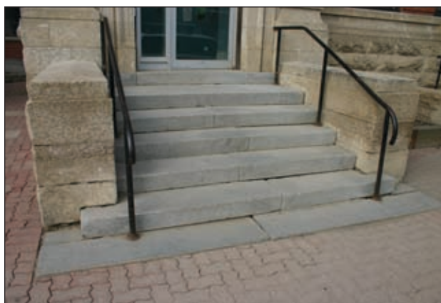
Il faut inspecter ces marches, car le gel et le dégel les font se soulever. Un maçon devra peut-être les remettre à niveau.
