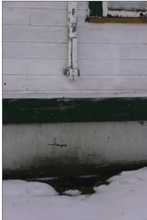
À cause d'un tuyau de descente manquant et du mauvais nivellement du sol, l'eau s'accumule à la base du bâtiment et peut causer de gros dégâts.
