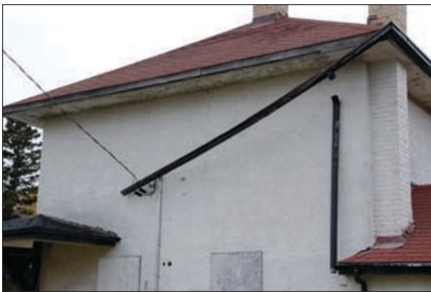
La gouttière est tombée sur une ligne d'électricité. Il ne s'agit plus seulement d'une question d'entretien mais d'un risque d'incendie.
