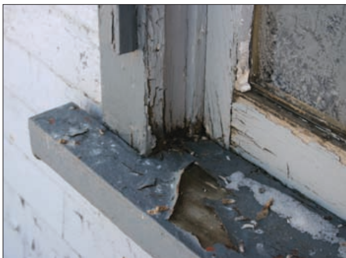
L'accumulation d'eau sur l'appui de fenêtre est à l'origine de l'effritement de la peinture et de la détérioration du bois. Il faut réparer le châssis et le dormant avec de la résine époxyde ou bien les remplacer s'ils sont vraiment pourris.
