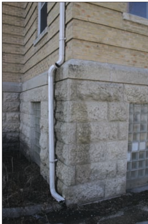
Ce tuyau de descente s'est détaché entre le premier et le deuxième étage, ce qui le rend totalement inefficace. Il lui manque aussi une descente pluviale pour éloigner l'eau du bâtiment, ce qui peut endommager les fondations.
