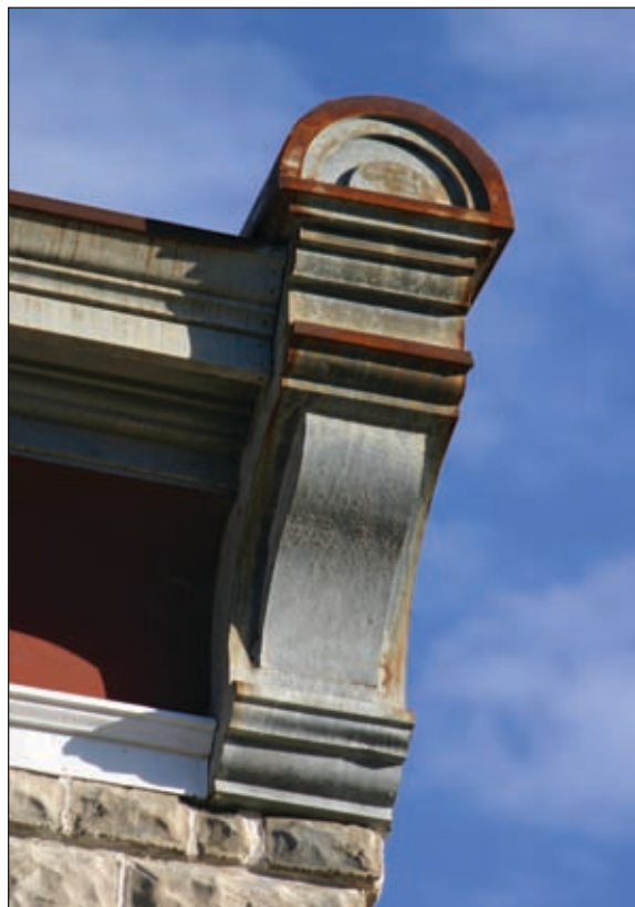
Cette console a besoin d'une couche de peinture pour empêcher la rouille de causer davantage de détérioration.
