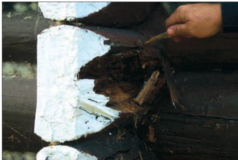
Ce rondin a été endommagé par l'eau. Cherchez d'où provient cette eau et remédiez à la cause de la détérioration avant de remplacer le rondin.
