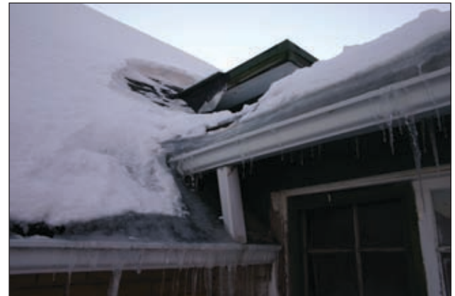
La glace s'est accumulée au niveau du débord de toit et risque d'endommager la ligne de toiture. Le meilleur remède est d'améliorer l'isolation dans les combles et de sceller toutes les fuites.
